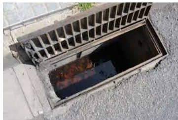
Figura 7. Imágenes de acumulaciones de aguas estancadas en las que se puede producir el crecimiento de larvas de mosquitos.
